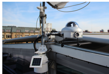
Ambient sensors (roof)
